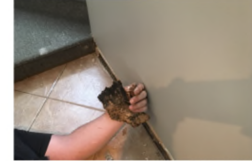
Identification problème de moisissure durant intervention / Signalement avec Rapport d'intervention
